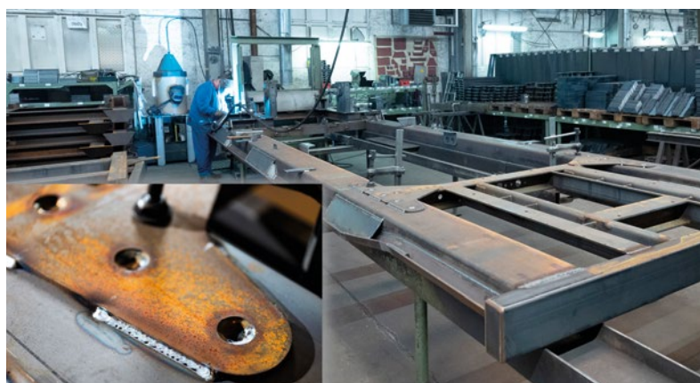
Das innovative Schweißverfahren forceArc puls wird in allen Bereichen des Stahlbaus zum Verschweißen unbehandelten Schwarzstahls eingesetzt. Die Prozesssicherheit ist hoch und die nahezu spritzerfreie Naht perfekt.
