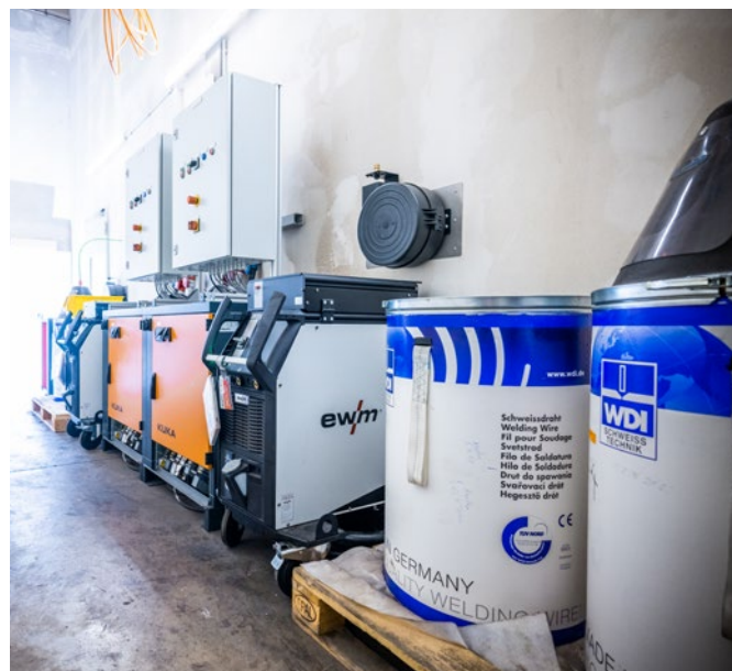
Die Anlagensteuerung, die Schweißgeräte und der Zusatzwerkstoff in den Fässern befinden sich hinter der Rückwand der Schweißkabine, um dem Schmutz nicht ausgesetzt zu sein.
